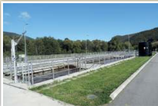
ČOV Liptovská Osada
