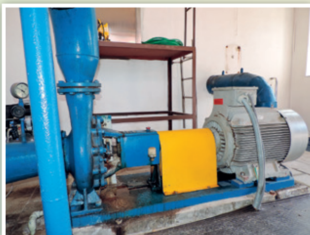
Vodárenský objekt – MVE Liptovská Osada
